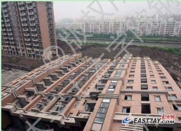
图 1.6 上海 13 层在建住宅楼整体倒塌
