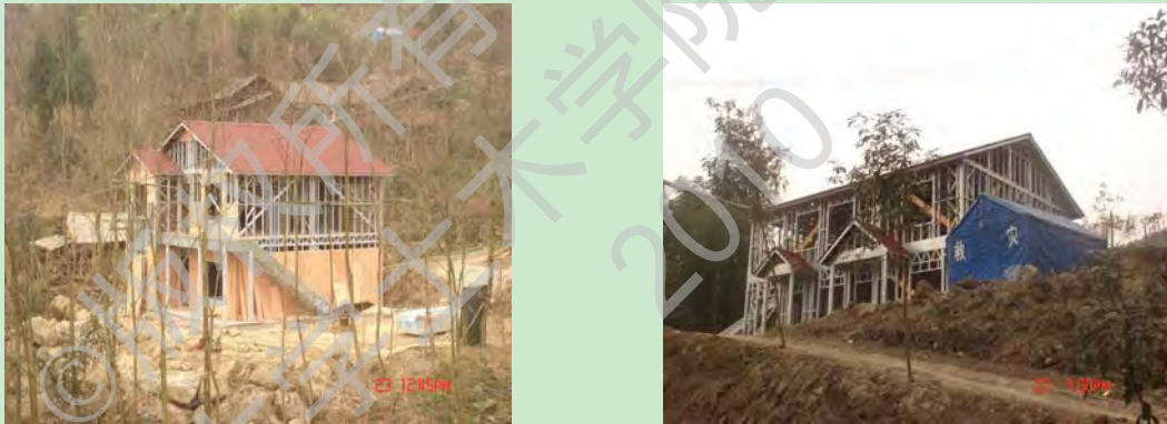
图 1.8 灾区重建中的冷弯薄壁型钢住宅
