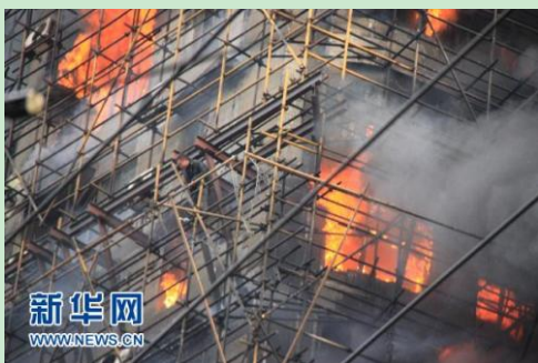
图 1.1 上海胶州路大楼火灾 [1]
