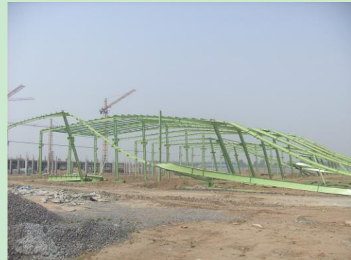
图 1.3 青州一在建车间施工期间倒塌
