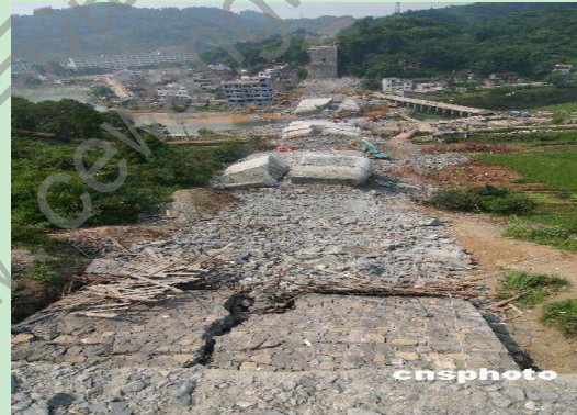
(b) 湖南凤凰大桥坍塌后
