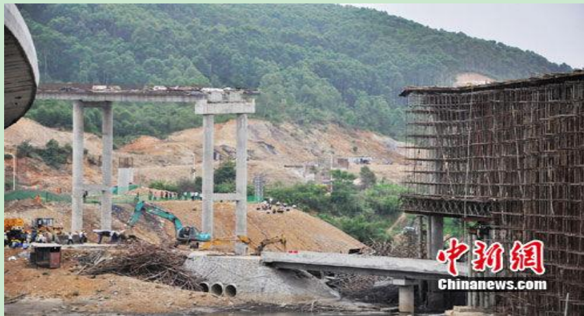
图 1.4 广东韶关韶赣高速公路马坝互通立交桥施工期间倒塌
