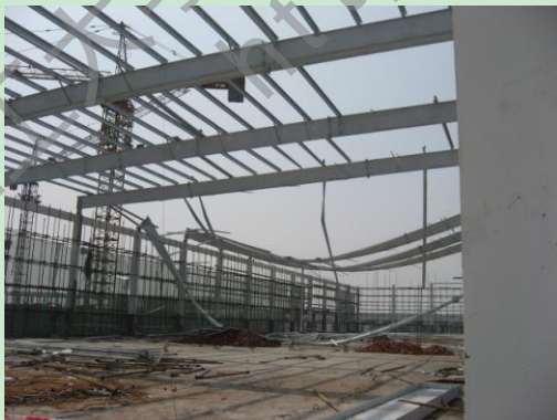
图 1.2 重庆一在建钢结构厂房施工期间倒塌
