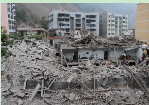
图 1.8 汶川地震中房屋的倒塌
